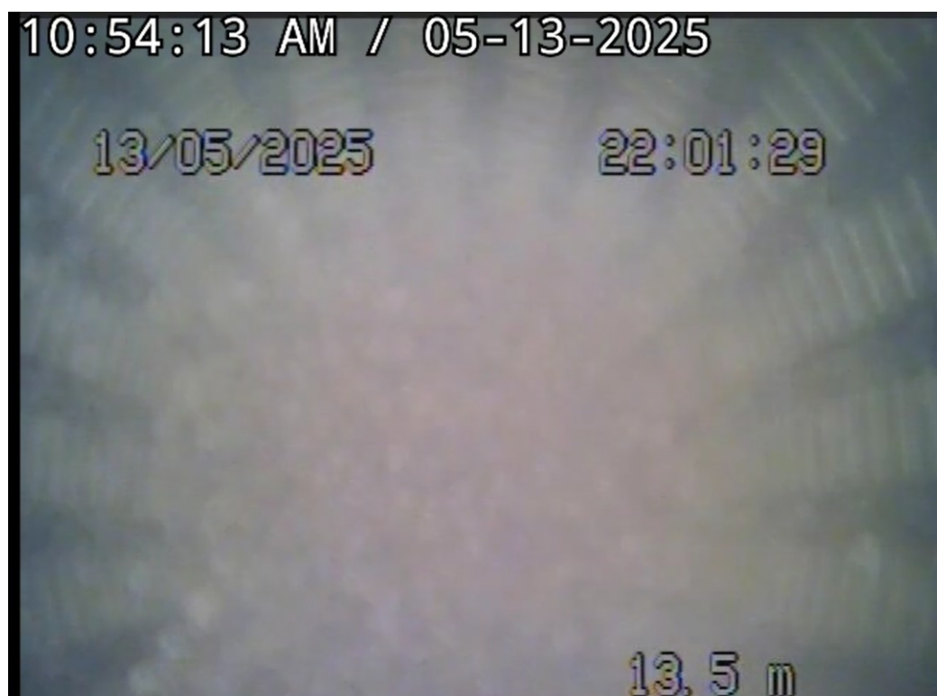
Figur 5: Videoinspektion af boring 83.1703 med Johnsonfilter (indtag 1), udført 13. maj 2025. Billede er fra filterintervallet i boringen. Der er et højt indhold af suspenderet materiale i boringen, der giver lav sigtbarhed.
