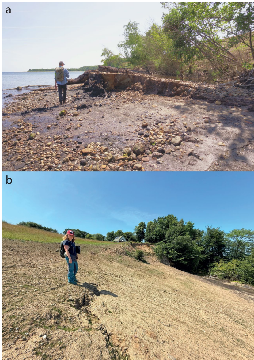
Figur 8. Feltfotos fra besigtigelsen den 20. juni 2025. a) Opløft af skredtåen nede ved kysten. Stranden, hvor personen går, ville før skredhændelsen have ligget under ca. ½ meter vand. b) De 30 cm brede sprækker langs bagvæggen af landskreddet ses lige nedenfor personen. Se Figur 7 for placeringen af billederne. Fotos fra GEUS.
