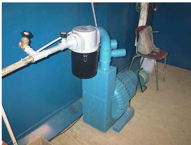
Figur 30. Rielschle pumpe med vandfilter.
